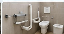
ห้องน้ำ/ห้องน้ำคนพิการ
